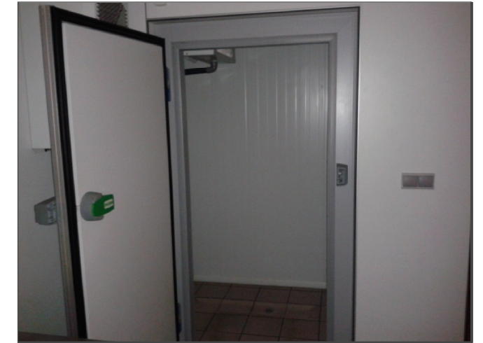
(f) CÁMARA FRIGORÍFICA
